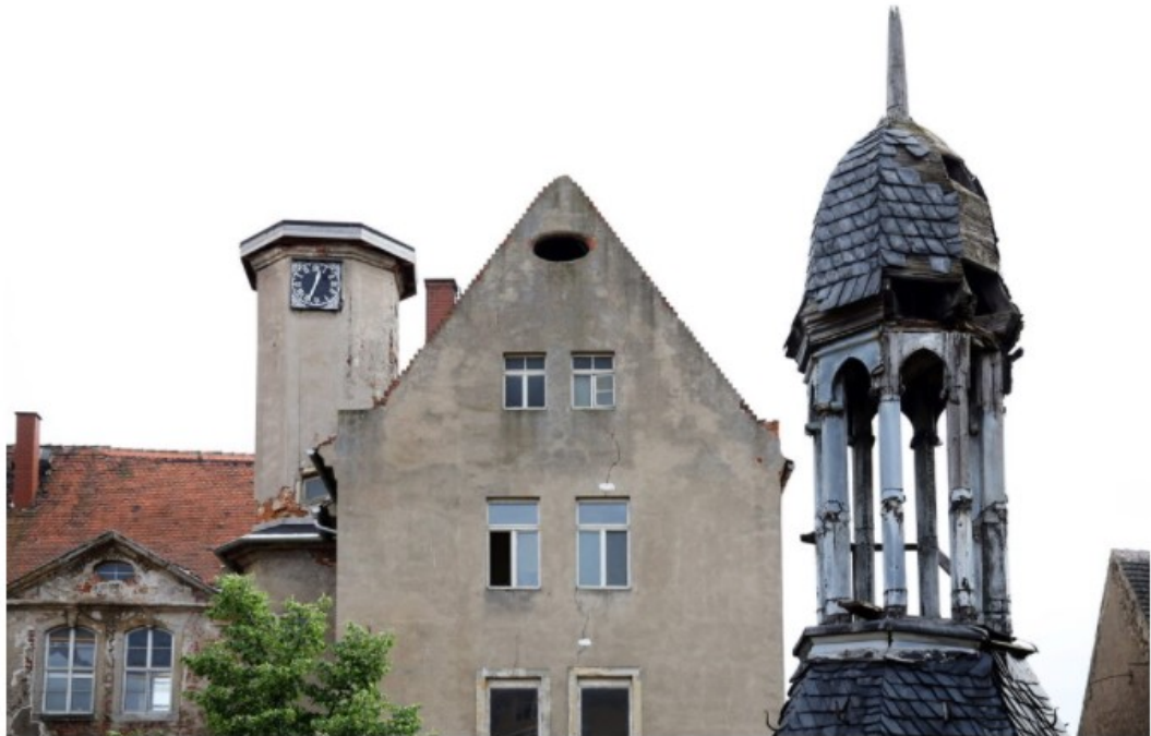
Die Turmhaube (rechts) ist vom Turm (links) heruntergenommen worden und soll restauriert werden. © Sebastian Schultz
